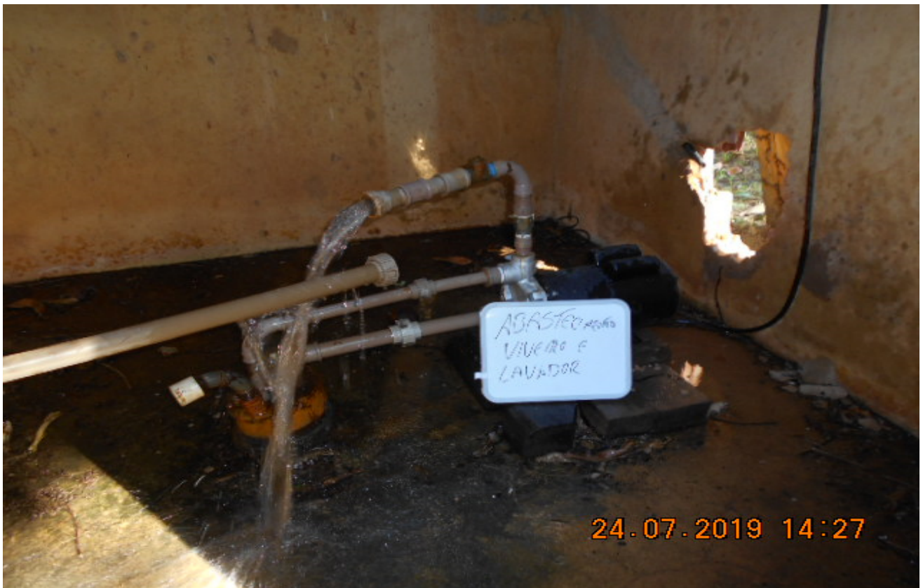
Figura 7 - Registro fotográfico do ponto de amostragem Abastecimento Viveiro e Lavador .
